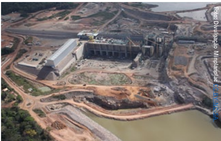
Vista aérea das obras da hidrelétrica Santo Antônio no rio Madeira (RO) em junho deste ano.
